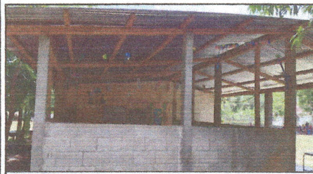
FOTOGRAFIA 5: Se observa la estructura de techo de madera la cual sera sustituida por estructura de techo de metal galvanizado.
