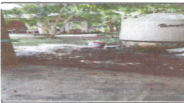
FOTOGRAFIA 6: Se observa el estado del piso de torta de concreto del pacillo y la base para tinaco en mal estado.
