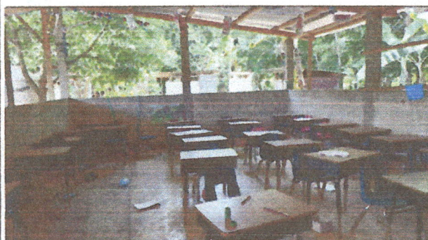
FOTOGRAFIA 3: Se observa el aula sin ventanas, por lo que se instalaran ventanas de PVC para crear un ambiente mas agradable para los estudiantes.
